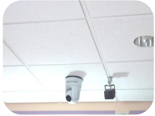
cámara y altavoz en el techo
